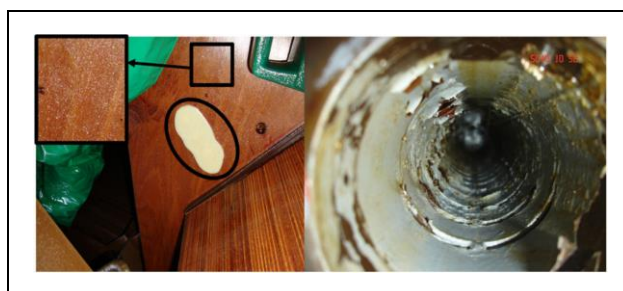
شکل (پ-۵-۳): تصاویر درون ترانسفورماتور و نقاطی که رنگ درون رادیاتور جدا شده است.
